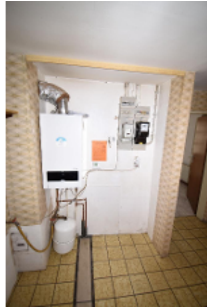
Heizung und E-Kasten
