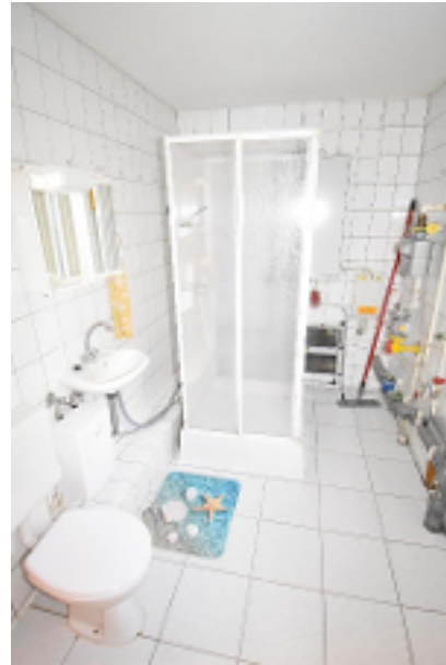
Dusche im Keller
